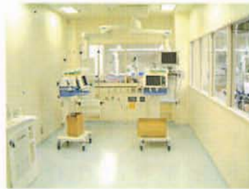
ICU内の隔離用室 室内の圧を陽圧、陰圧に切りかえ可能
